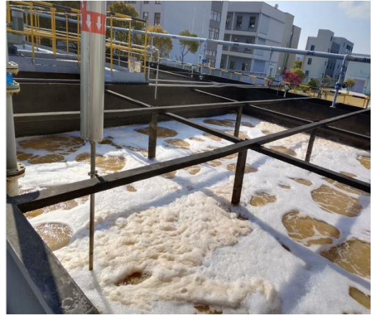
废水处理设施
