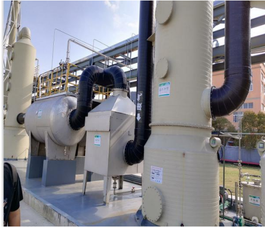
DA001 废气处理装置（喷淋+活性炭+喷淋）
