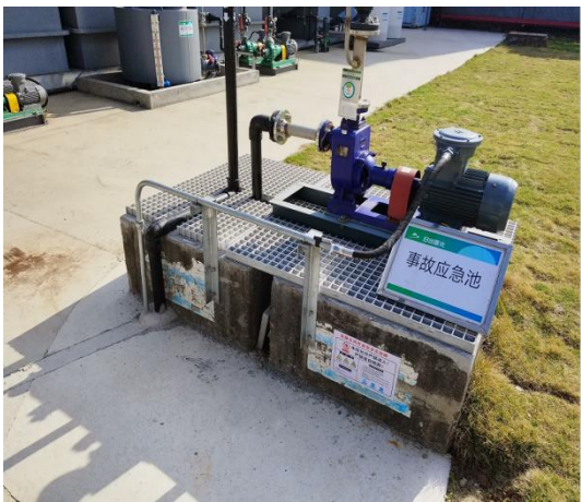
地下事故应急池
